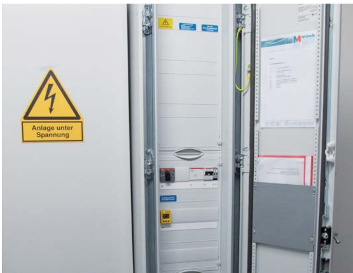
IT-Verteiler mit Trafo 6,3 kVA
